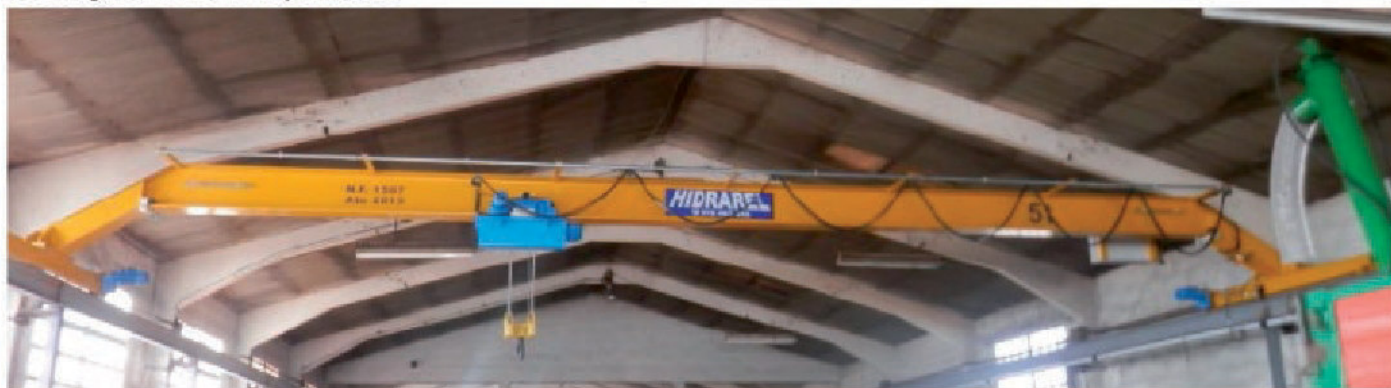
Puente grúa monorraíl suspendido
