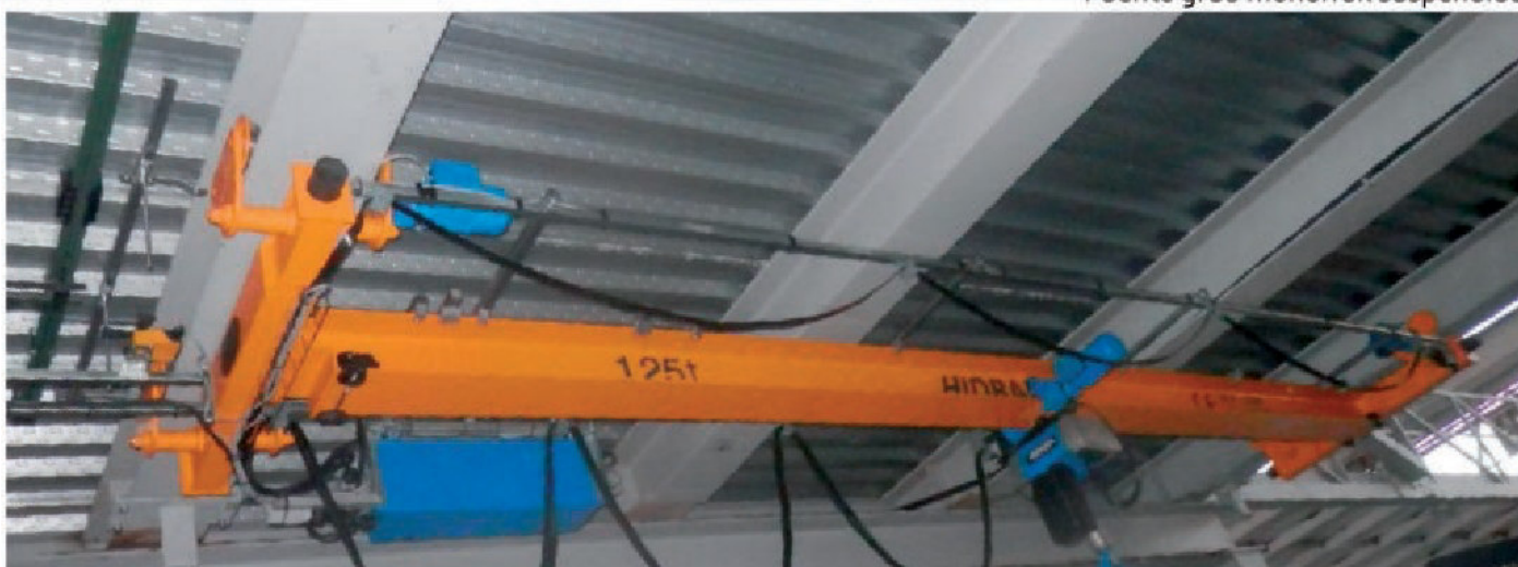
Puente grúa monorraíl
