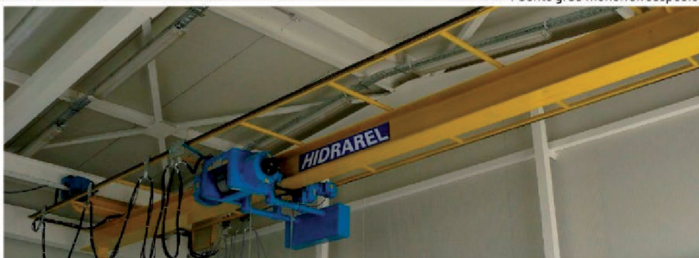
Puente grúa monorraíl suspendido
